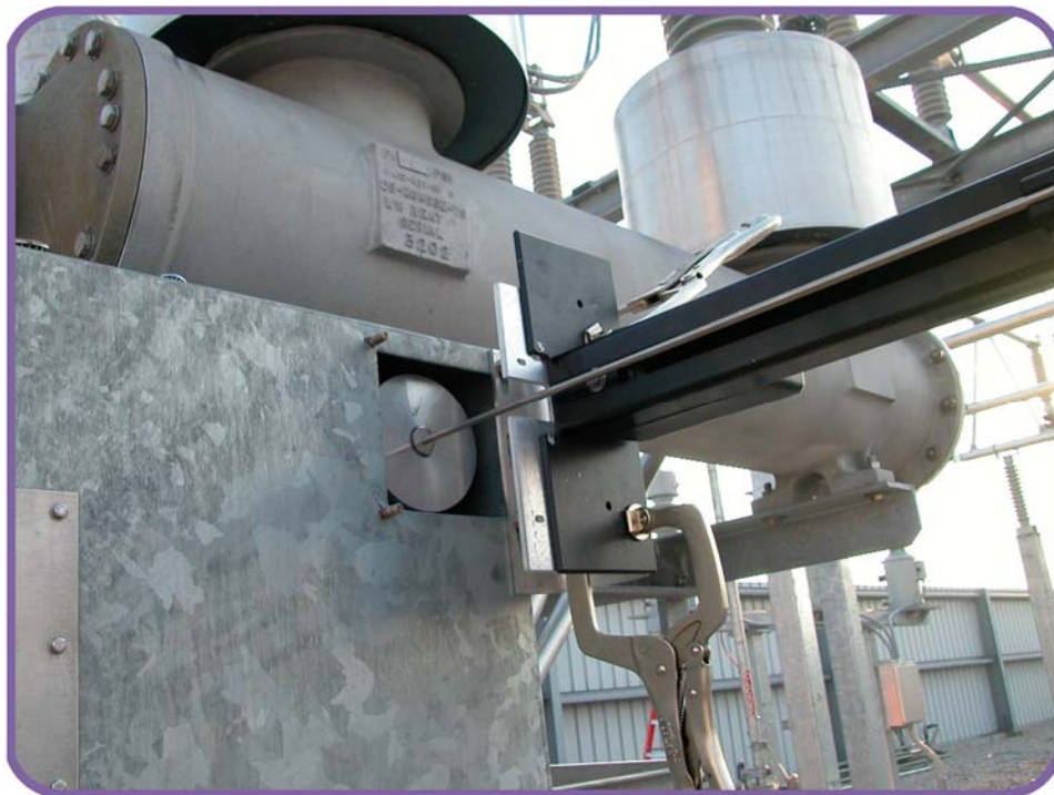
Figura 34. Transductor Lineal en un interruptor Areva DT1-72.5F
