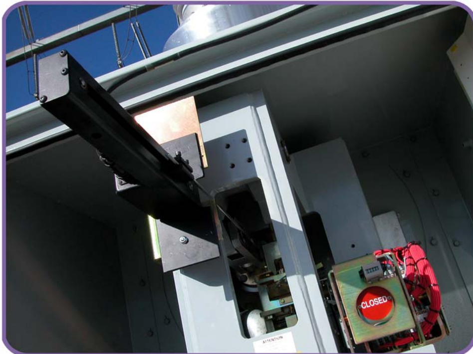
Figura 33. Transductor Lineal en un interruptor Mitsubishi 500-SFMT
