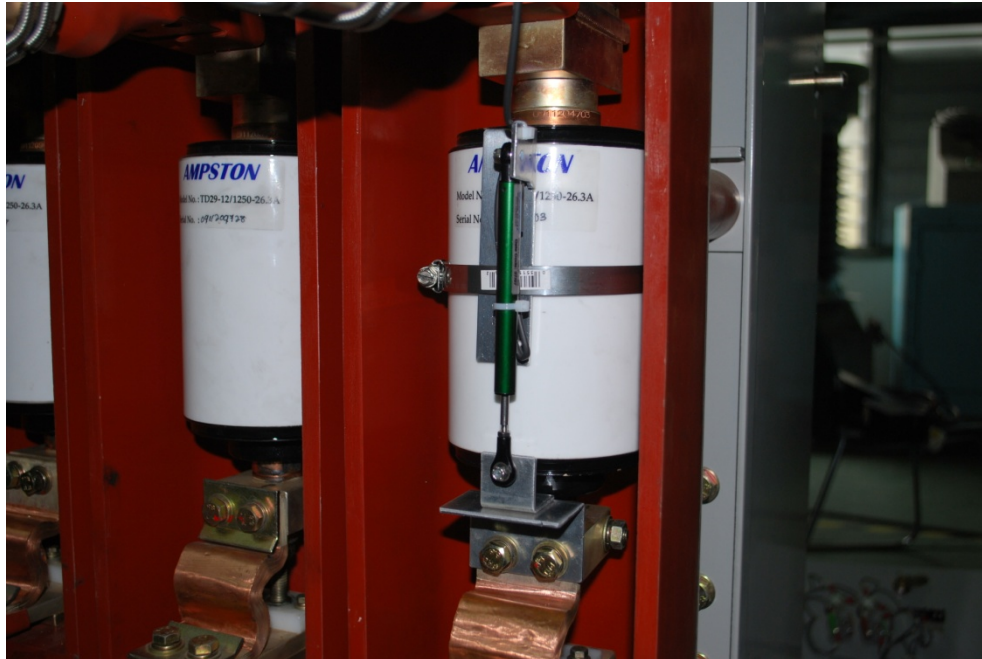
Transductor Resistivo en Interruptor en Vacío
