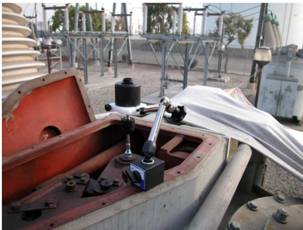
Transductor Rotacional en un interruptor Federal Pacific
