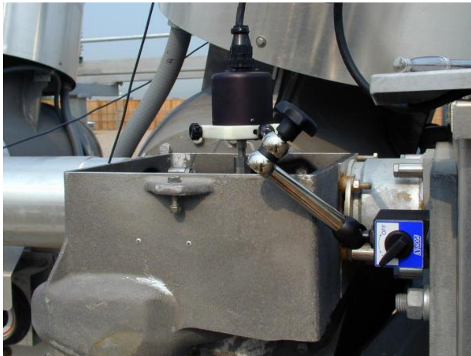
Transductor Rotacional en un interruptor Alstom HE 1014
